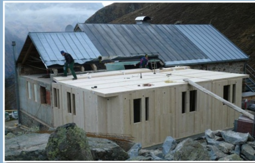
Bereits Mitte Oktober steht das Erdgeschoss mit der Pächterwohnung und der Küchenerweiterung.
