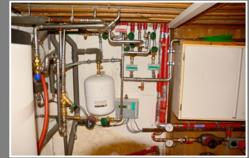
Installation im Keller für Frisch- und Warmwasser
